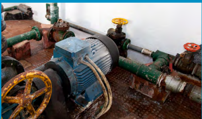
Aquisição Bombas para os Furos de Água
