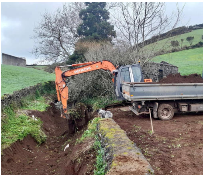
Limpeza e manutenção de Ribeira, em articulação com as Juntas de Freguesia.
