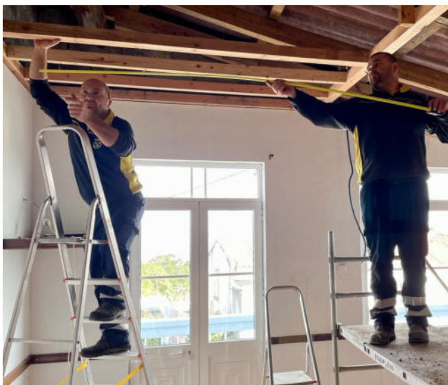
Obras de reabilitação do Bar da Sede da Sociedade Filarmónica Recreio Nortense.
