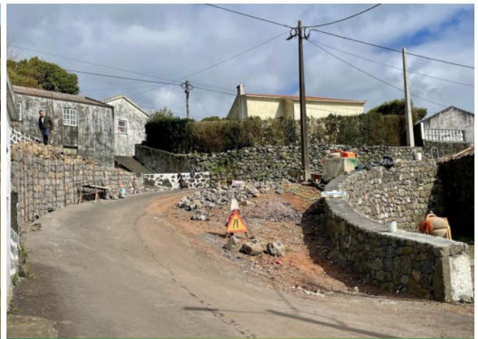
Obras de correção de Via Municipal, no Lugar do Ribeirinho, Beira, em articulação com a Junta de Freguesia de Velas.
