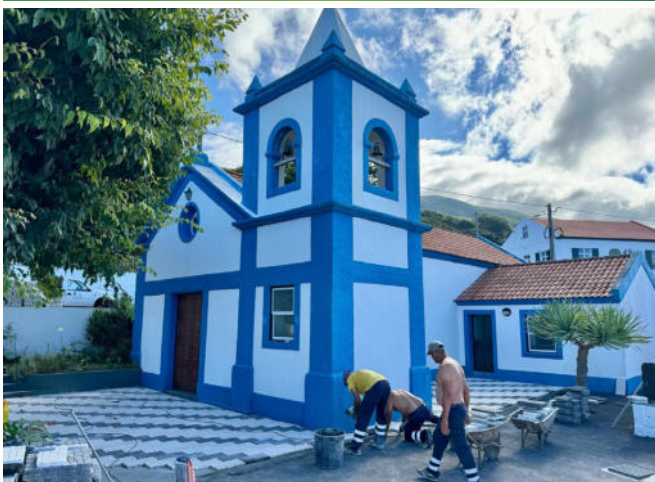
Obras de melhoria do adro da Ermida da Senhora da Encarnação, no Lugar da Ribeira do Nabo.
