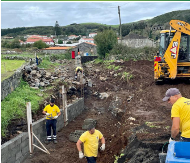
Reconstrução de muros na ribeira adjacente à Canada da Moagem, em articulação com a Junta de Freguesia dos Rosais.
