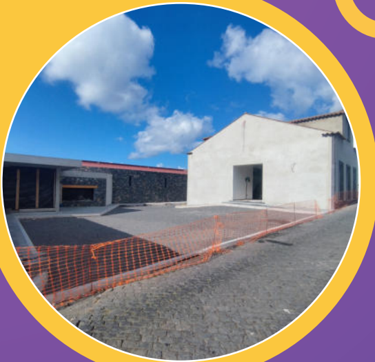
Fiscalização da Empreitada do Parque de Estacionamento da Rua de São João e Reabilitação de Imóvel
