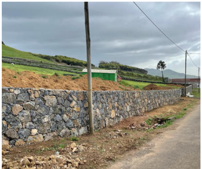
Reparação e construção de paredes de suporte e proteção no lugar da Cancela Grande, em articulação com a Junta de Freguesia dos Rosais
